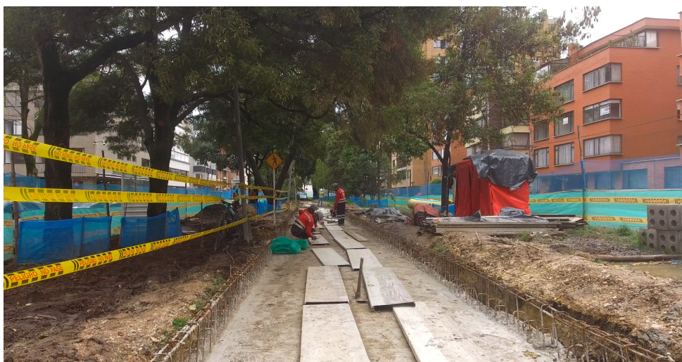
Para la Contraloría de Bogotá es preocupante que las obras de aceras y ciclorutas de las calles 92 y 94 apenas tengan un avance físico cercano al siete por ciento, dado que, según el cronograma de ejecución, debería estar en el 57 por ciento. La construcción de esta obra de valorización inició en diciembre de 2020, con un plazo inicial de ejecución de 20 meses.
